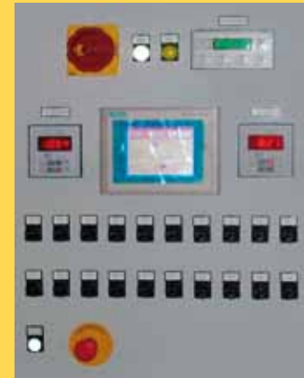
Quadro elettrico - Switchboard
